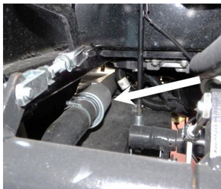
Rys. 5.9.2. filtr oleju hydraulicznego wstępnego oczyszczania
